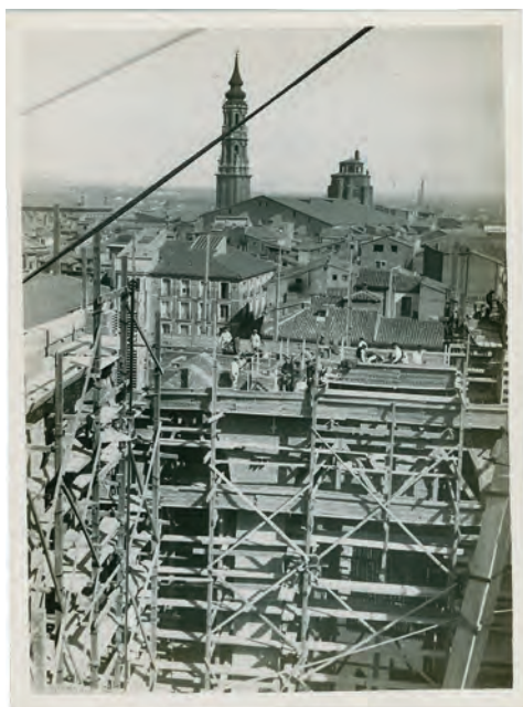
FIG. 6. Vista del muro interior de la fachada principal, semiculta por los impresionantes andamiajes; al fondo la torre y el cimborrio de la Seo. Marín Chivite (1930-1931).
