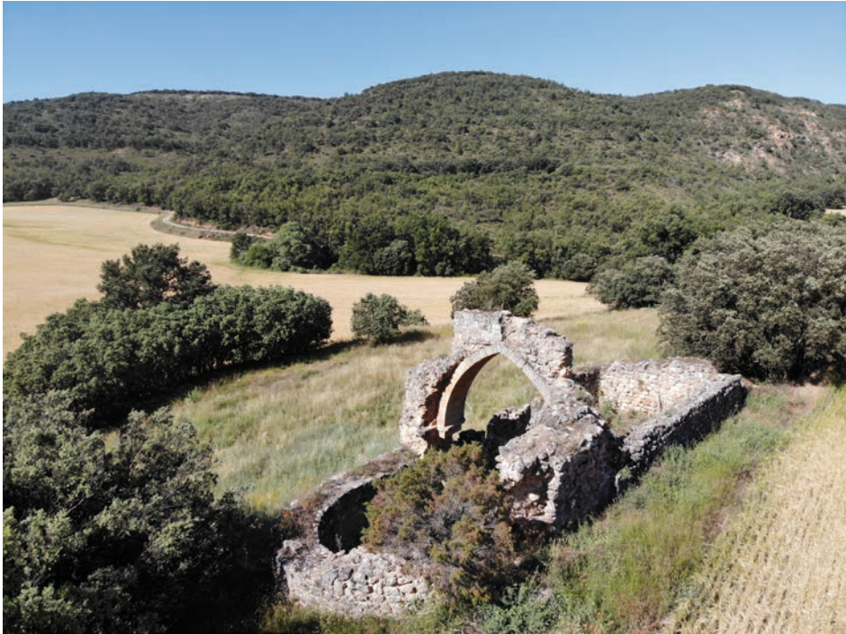
Lám. 51. Ruinas de la iglesia del despoblado de Ferruñuela, Brihuega, Guadalajara. Principios del siglo XIII.
