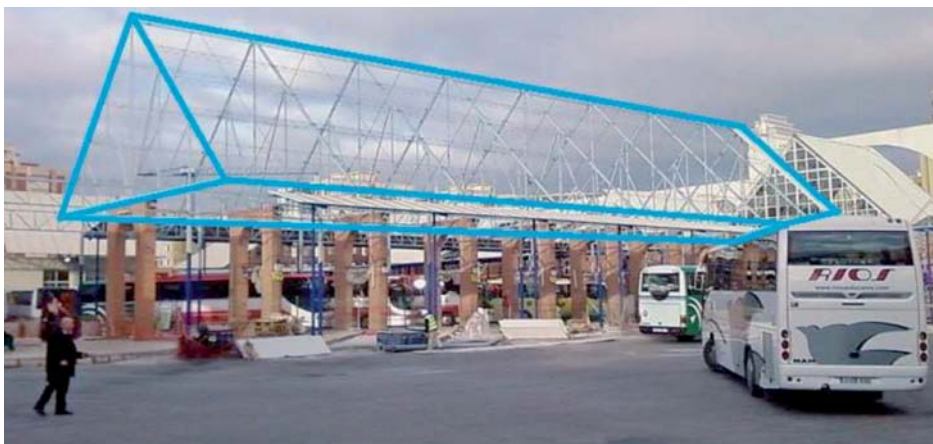
Figura 6. Imagen a ras de suelo de la estación de autobuses señalando en azul parte del tejado destruido.
