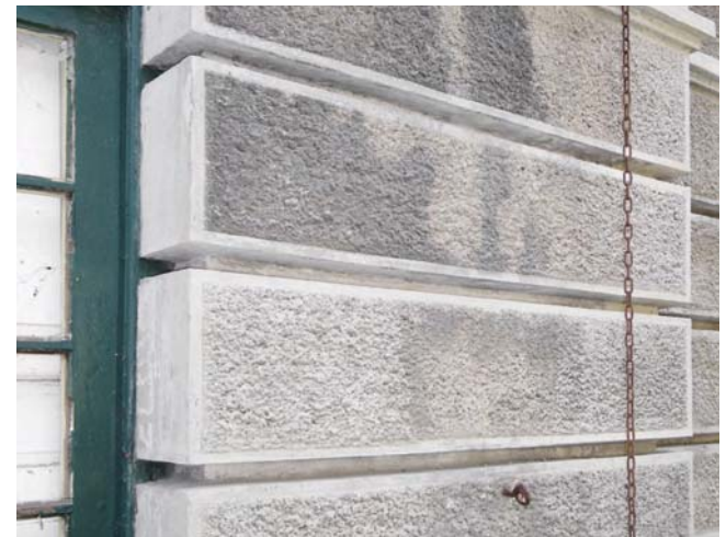
Figura 5. Fachada de la Estación Internacional de Canfranc de hormigón armado trasdosado de fábrica hacia el exterior.
