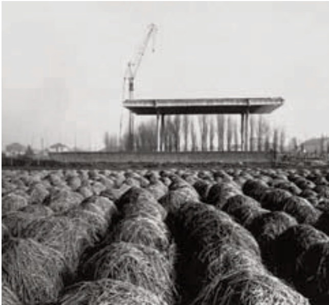
Iglesia de Baranzate. La estructura de la cubierta, ya sobre sus apoyos, suspendida sobre los campos de cultivo. Fotografía de Giorgio Casali
