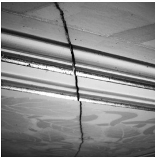
10. Grieta localizada en la habitación 2.
