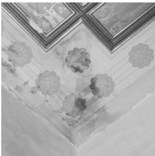
12. Manchas de humedad de la habitación 3.
