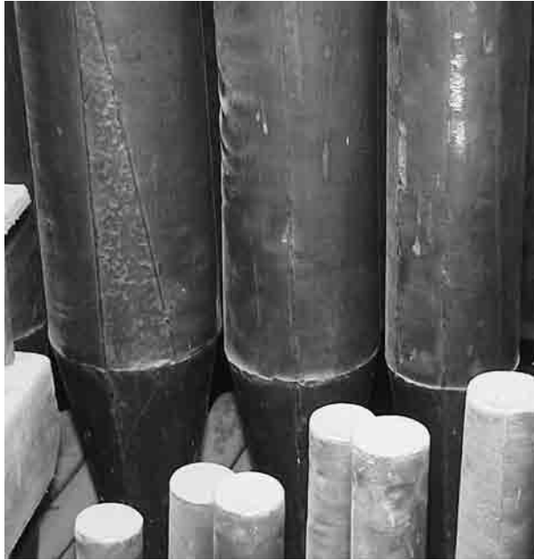
En el tubo de la izquierda, antes de la restauración: detalle de un “apaño” hecho en la tubería de fachada del flautado mayor.
